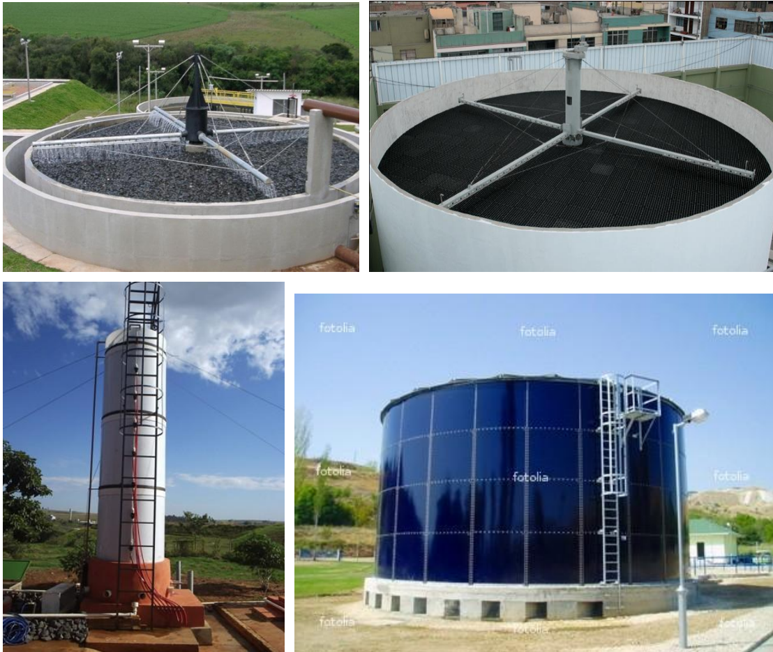
Figura 20. Exemplos de Filtro Biológicos Percoladores utilizados para o tratamento de águas residuárias.
