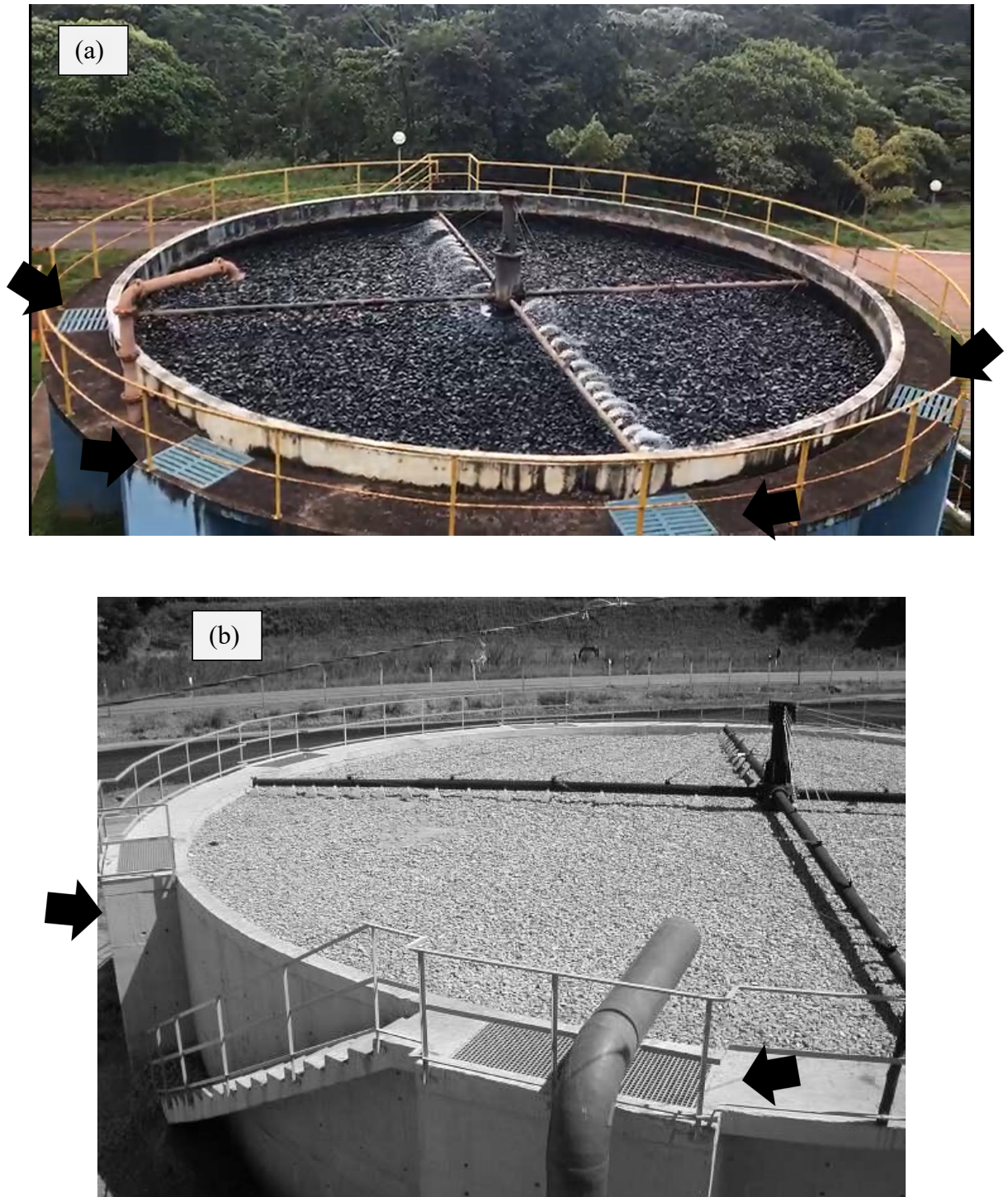
Figura 24. Poços do sistema de ventilação de FBP: (a) ETE SEMAE - Itabirito MG; (b) ETE SEMAE – Itabira MG.
