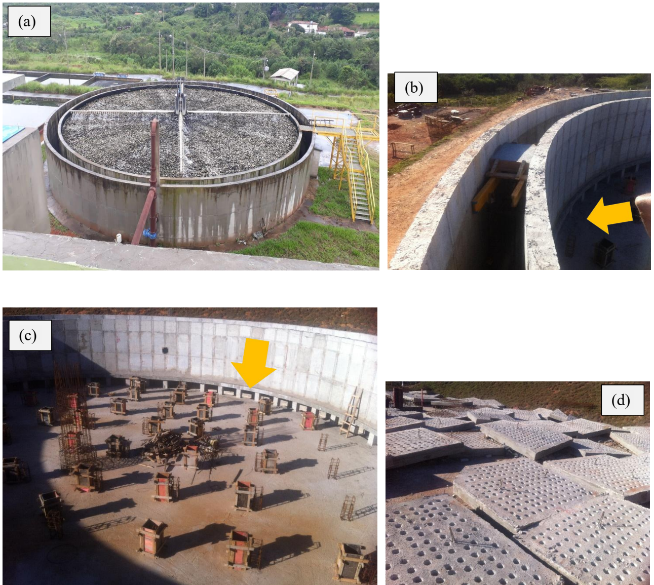
Figura 25. FBP da ETE COPASA – Rancho Novo em Conselheiro Lafaiete: (a) FBP com dois anéis de concreto pré-moldado; (b) Canela de drenagem do efluente tratado (entre as paredes do FBP) com indicação da entrada nas janelas do fundo falso; (c) Fundo do FBP com detalhes das janelas de ventilação e de entrada do líquido na canaleta de drenagem e; (d) Laje perfurada em pré-moldado.
