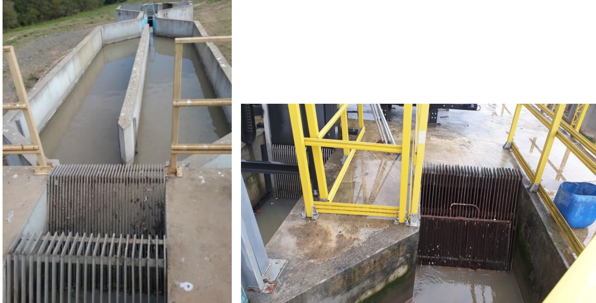
Figura 8. Unidades de gradeamento em plantas de tratamento de esgotos sanitários.
